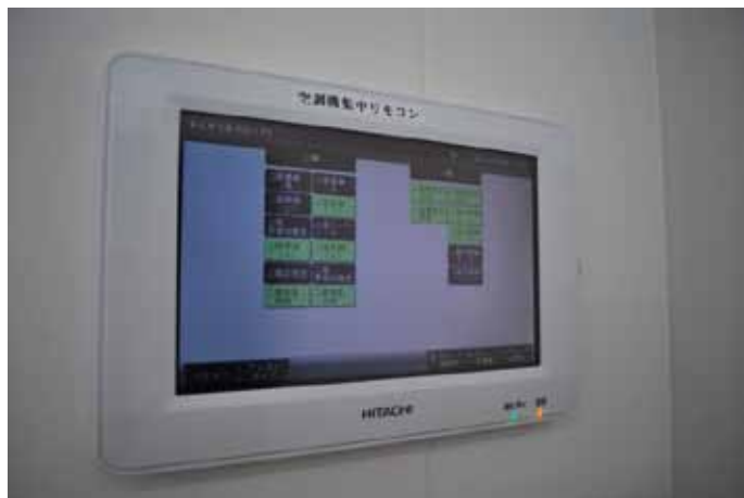
空調一括管理システム。社屋の空調を管理して省エネ・経費削減に取り組む
