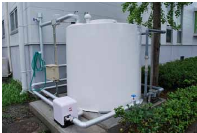
熊本の豊富な地下湧水をろ過し作業用水として活用する為のタンク
